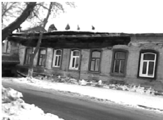
Ул. 9 Января. После снегопада рухнула крыша. Крышу устанавливают заново
